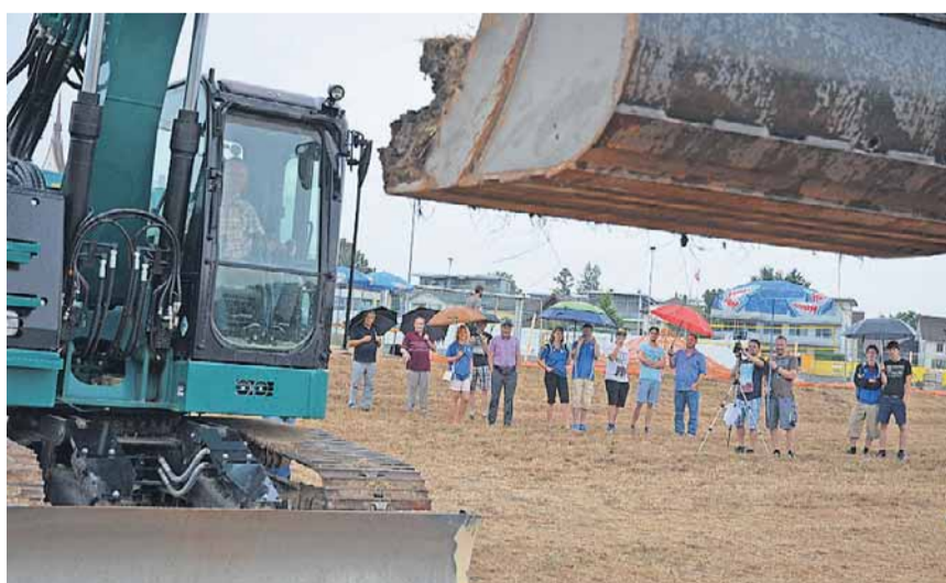
Gemeindeammann Hannes Küng machte den Spatenstich mit dem Bagger; für Schaufeln wäre der Boden schlicht zu trocken und zu hart gewesen.
